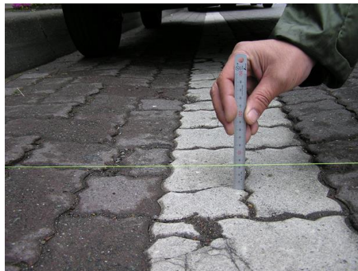
写真1 路盤の支持力不足によりわだち掘れが生じた例
