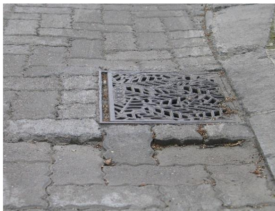
写真2 雨水柵周りの沈下の例
